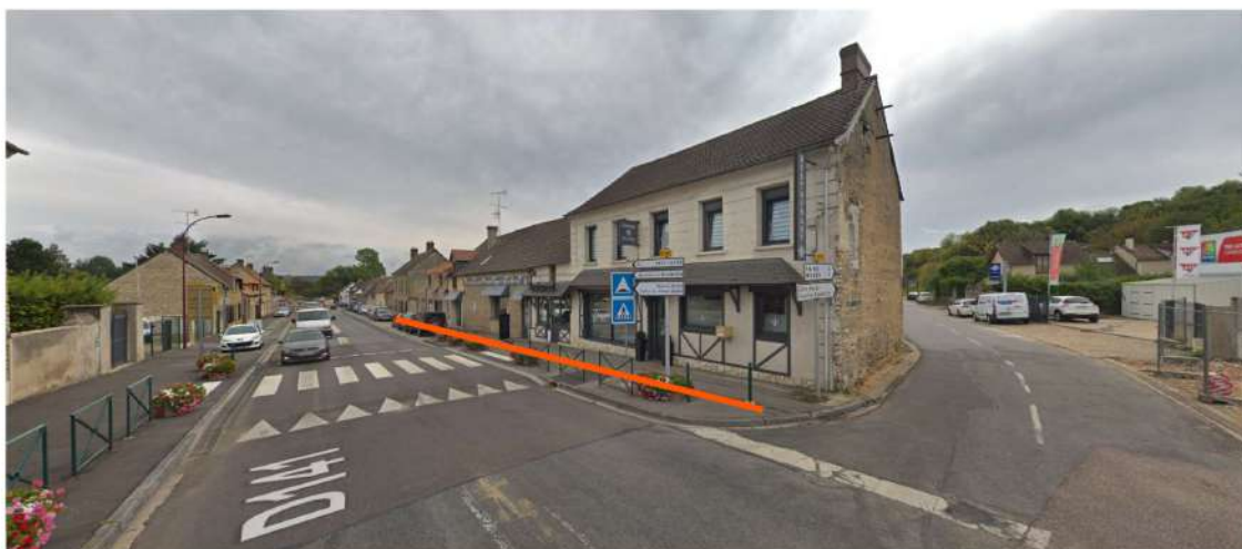
Pacy sur Eure, rue Ledoux Réalisation de trottoirs et stationnement - côté impair (section rue Pierrefeu / rue de la Côte Blanche)
